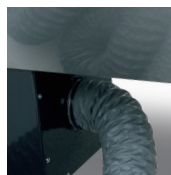
Подключение к наружному воздуху предотвращает загрязнение горелки
